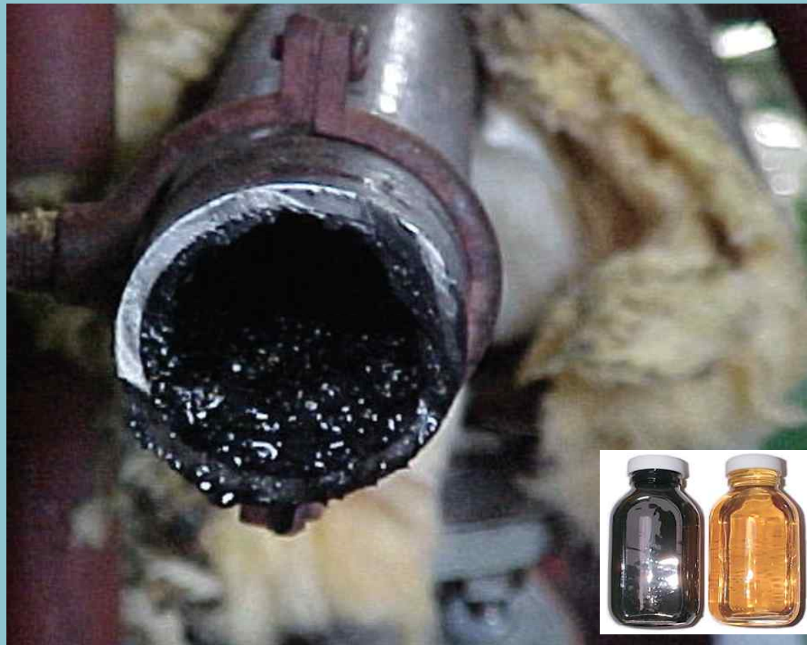
Manutenzione di un sistema di olio diatermico
