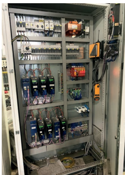
La soluzione horner installata sulla macchina per la cardatura
