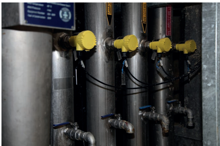
Misure di pressione con il VEGABAR 82 – Impianto di depurazione (cleaner)
